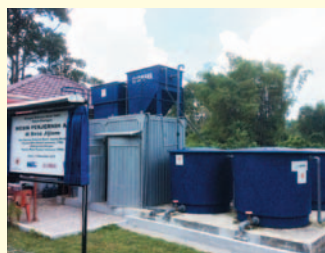
村に設置された浄水装置
