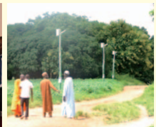
中央市場までの道路に整備された ソーラー街灯
